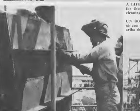
ELECTRICIENAN NA trabu, ta traha na e generador di Esso Oranjestad mientras cu machinistan ta inspecta e mecanismo di diesel cu ta su propulsiun principal. Un welder ta traha ariba su awanta di proteccion na su proa, torante cual detayenan ta wordé muestrá den e otro dos portretinan. Yegando na su turno, Esso San Nicolas ta ocupa e lugar di marrá for di cual Esso Oranjestad a caba di sali, mira-ira e ta prepara pa un controlamento similar entre e stelas, banda dreci.
